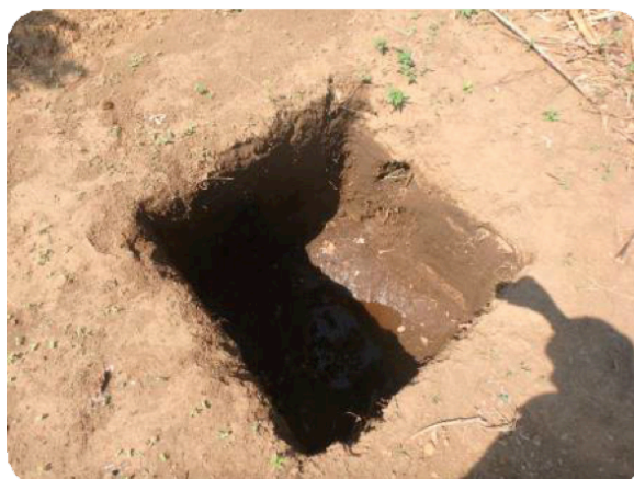
Figura 5. Fosa de Infiltración.
